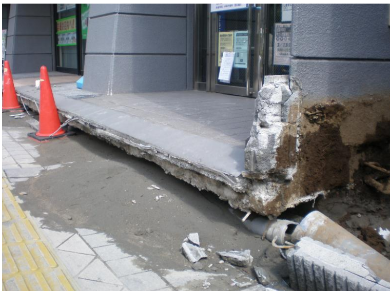
液状化による被害状況 1
