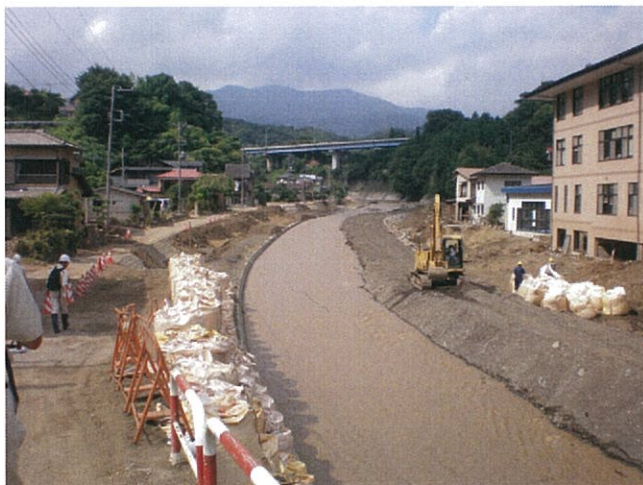
浸水被害が集中した野沢川沿川（中流）
